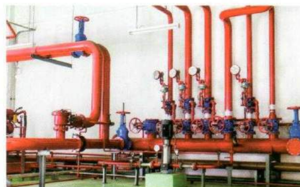
Ứng dụng trong phòng cháy chữa cháy Application of fire protection
